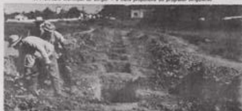
A administração municipal expande os trabalhos de distribuição das redes de água e esgoto
